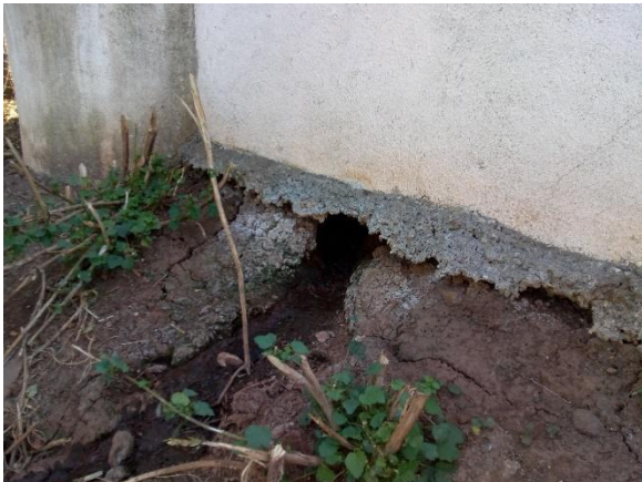
Sistema dos, fotografía por Dalia Tinoco. No se puede ver la grieta en el biofiltro, pero se puede observar como el paso del agua hizo un camino y deslavo la tierra.
