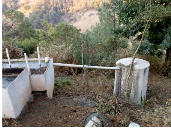
Sistema cuatro, fotografía por Dalia Tinoco. Colector final desbordado por falta de salida de agua
