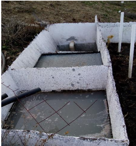
Sistema dos, fotografía por Dalia Tinoco. Trampa de grasas con desperfectos por lo que no almacena agua hasta el nivel recomendado.
