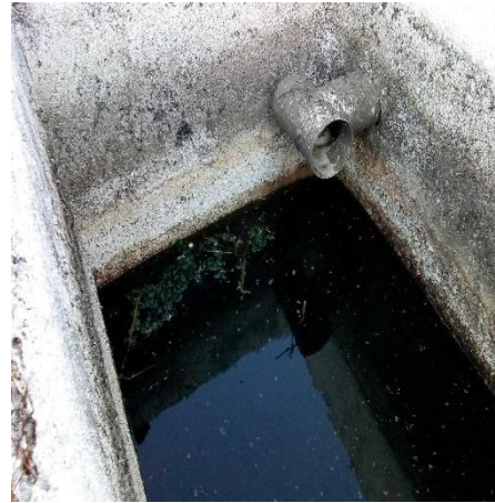
Sistema dos, fotografía por Dalia Tinoco Trampa de grasas con fuga por lo que no puede llenarse hasta el tubo conector.
