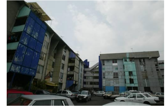
Imagen 2 Vecinos de la Unidad Infonavit Iztacalco aseguran que los edificios en los que viven tienen daños estructurales archivo La Jornada. Foto Yazmín Ortega Cortés
