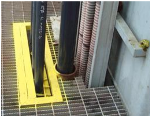
Imagen IV.2.3. Protección para tubería conduit (Paso de rejilla).
