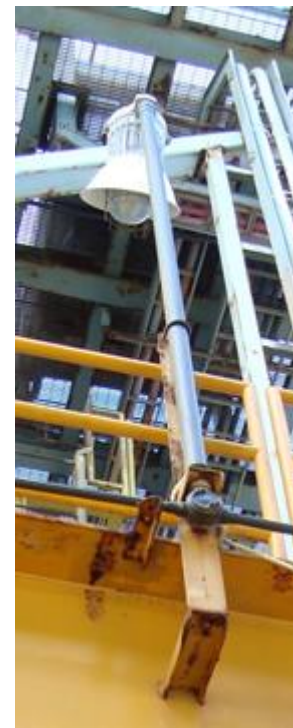
Imagen IV.2.4. Poste de Alumbrado Perimetral.
