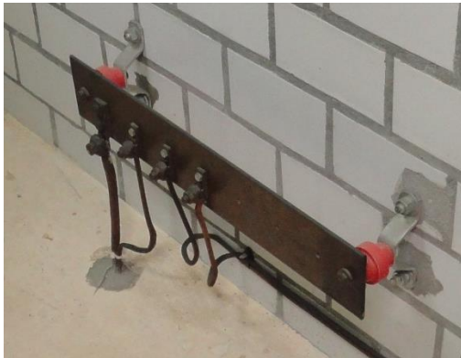
Imagen III.4.4. Barra de Puesta a Tierra Electrónica (En Tierra).
