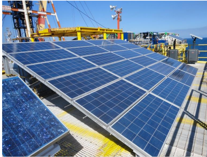
Imagen III.1.10. Arreglo Fotovoltaico en Plataforma Marina
