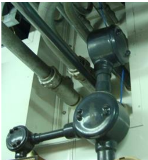
Imagen IV.2.1. Cajas de conexiones “L y T” y Condulets para sellar tubería.
