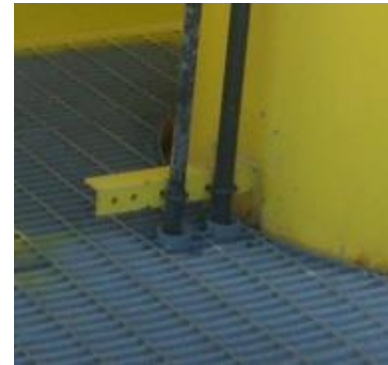
Imagen IV.2.2. Paso de rejilla y soportes para canalizaciones.
