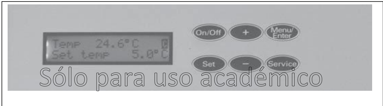
Figura 11 Imagen de unidad de control (Display del Contenedor)
