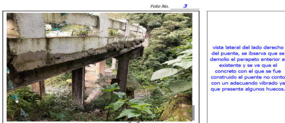
Figura 3.4 Ejemplo de reporte de daños (Levantamiento Geométrico)
