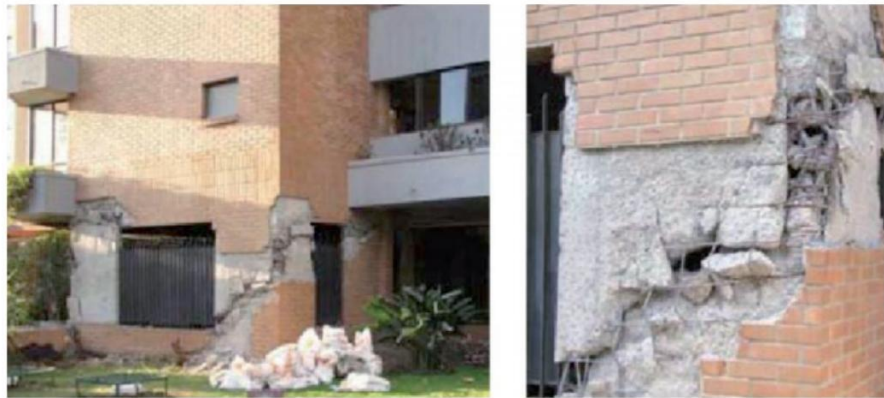
Figura 10. Falla por corte en un edificio en Viña del Mar (Chile), con trituración de los extremos y pandeo del refuerzo vertical no confinado. (San Bartolomé et al., 2011).
