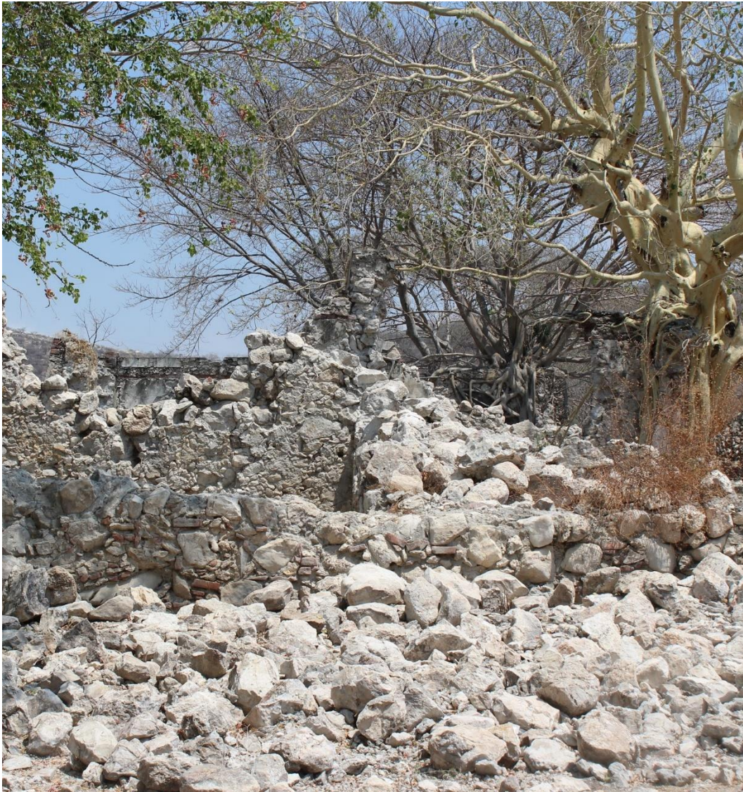
[Imagen III.4 ] Deterioros de la tienda de raya (Fotografía) de Valeria Medina Pimentel 2019
