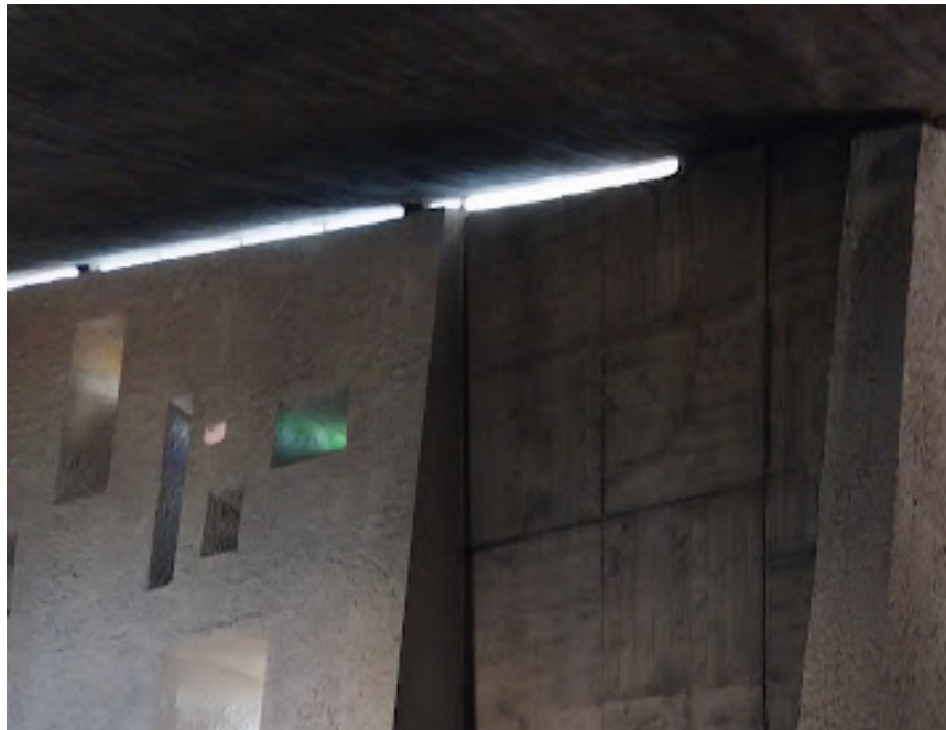
Figura 26: Detalle donde se aprecia la junta que separa los muros de la cubierta. Imagen: Joan Manuel Núñez Veloz.
