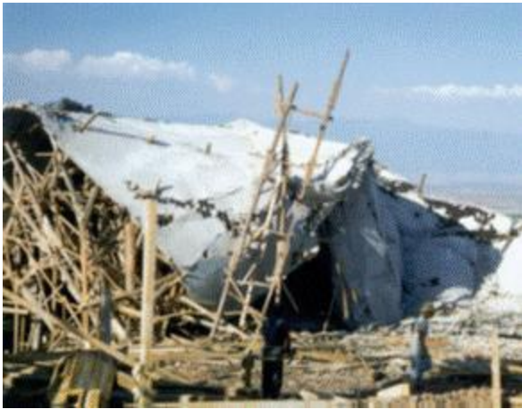
Figura 28 Colapso de la capilla abierta de Palmira
