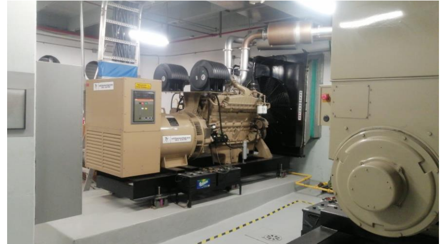
Imagen 39. Vista de planta de emergencia marca Cummins (autoría propia, marzo, 2020).
