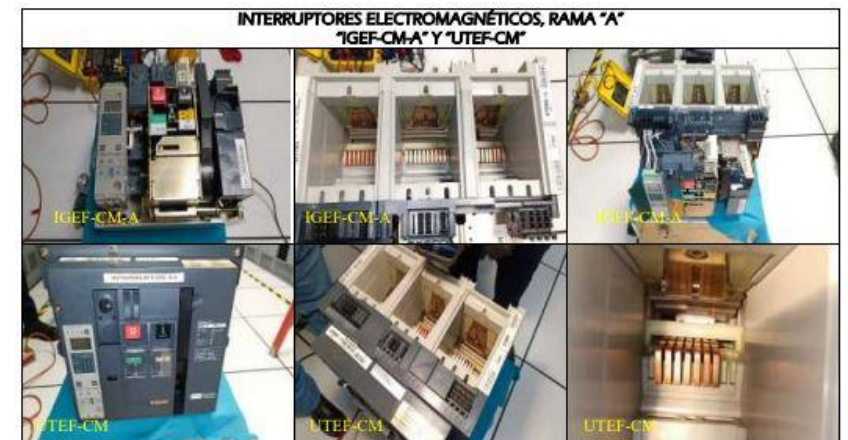
Imagen 35. Limpieza de ITM, cámaras de arqueo, contactos fijos y móviles (propiedad de IEESA).
