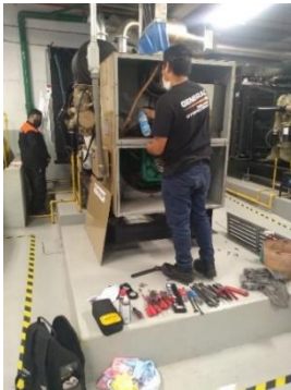
Imagen 38. Limpieza de generador eléctrico de la rama “B” (autoría propia).
