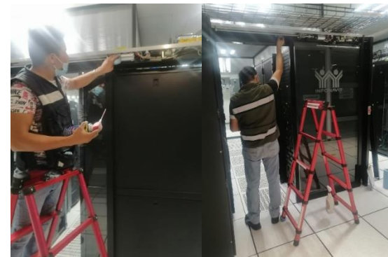
Imagen 49. Limpieza de puertas de pasillos fríos dentro del área del centro de cómputo (autoría propia).
