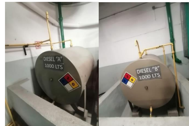
Imagen 55. Fotografía de los 2 tanques de cada generador eléctrico Rama "A" y "B" (autoría propia).
