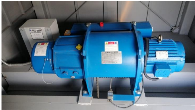
Imagen 50. Vista del motor de polipasto y controles (autoría propia, marzo, 2020)
