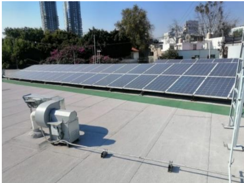
Imagen 53. Banco de paneles fotovoltaicos de 5KVA (autoría propia, Febrero, 2020).
