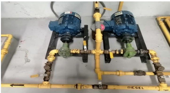
Imagen 56. Vista de las bombas de diésel, una para cada tanque de día (autoría propia)
