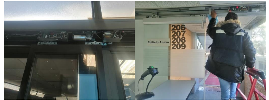
Imagen 48. Limpieza y revisión de carretillas, banda y módulo de control de apertura y cierre (autoría propia)
