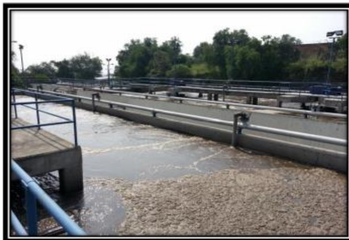
Figura 15. Vista general de uno de los reactores biológicos rectangulares de la planta.
