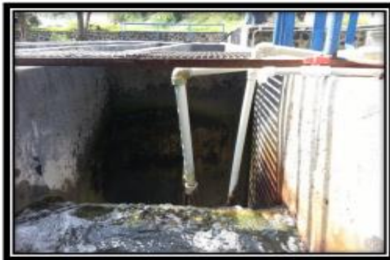
Figura 17. Instalación para la desinfección del efluente secundario con hipoclorito por goteo.
