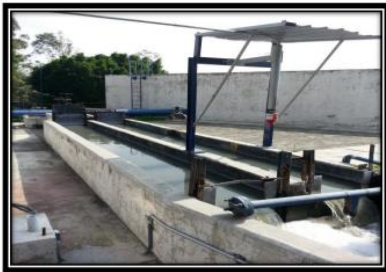
Figura 13. Canales desarenadores con su respectivo aparato de medición digital de gasto.
