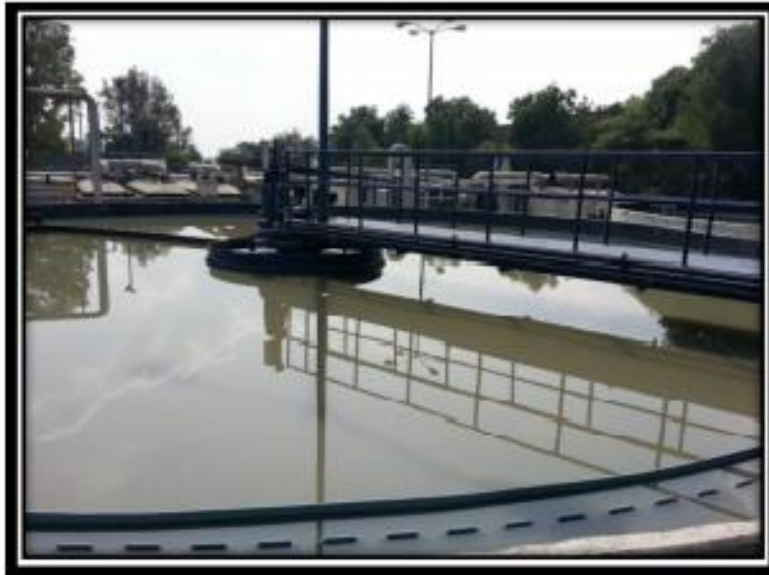
Figura 14. Vista general de uno de los sedimentadores circulares con que cuenta la planta de tratamiento
