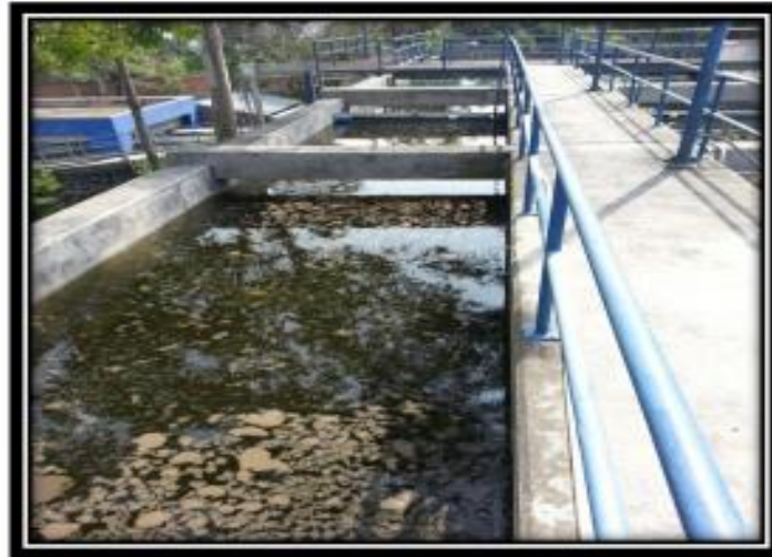
Figura 16. Sedimentador secundario, se almacenan los lodos en una tolva y se recirculan hacia los reactores biológicos.
