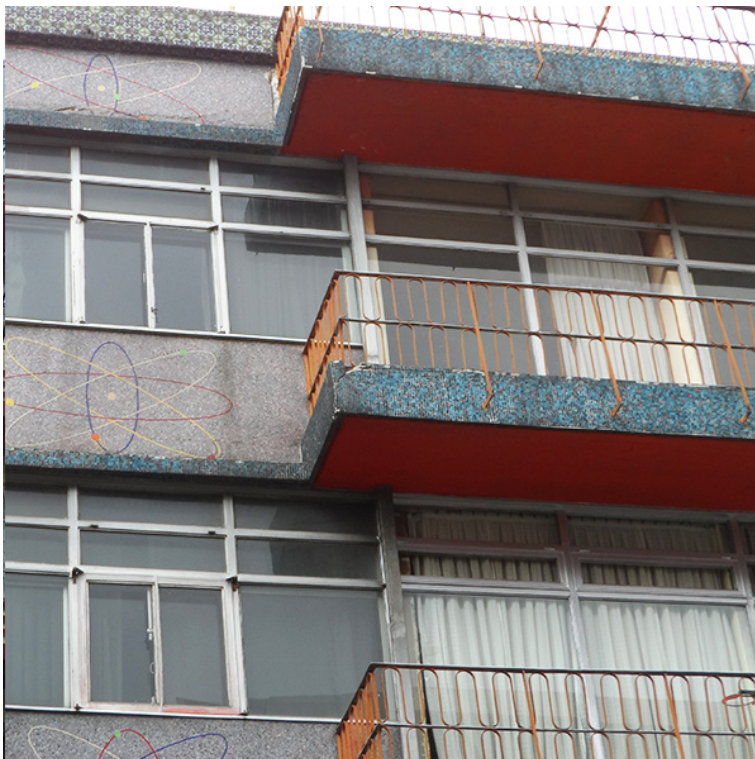
Mosaico fotográfico 5. Fachadas de edificios pre y post sismo 85.
