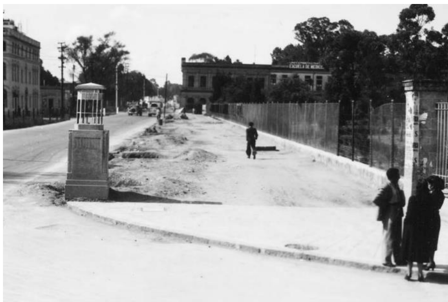
Figura 8. Pavimentación de la ampliación de la Calz. México – Tacuba en octubre de 1939.
