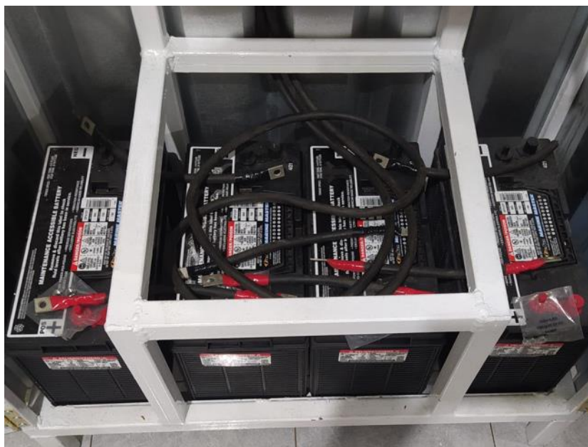
Figura 57. Arreglo de baterías
