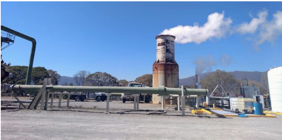
Figura 69. Operación del sistema geotérmico
