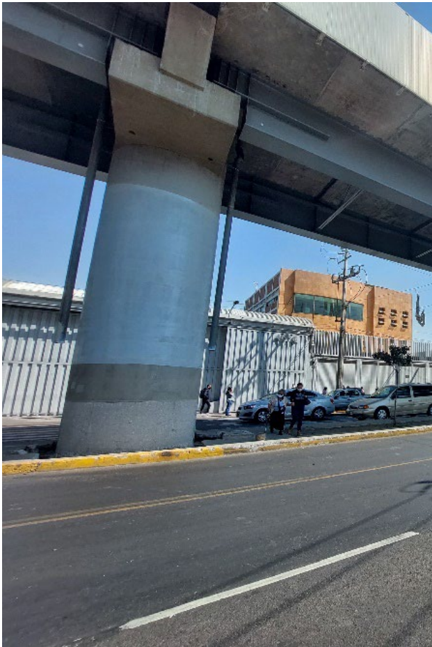
Imagen 45 Columnas con recubrimiento contra los rayos UV.
