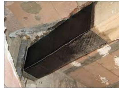
Imagen 8 Aplicación de Fibra de Carbono en elemento estructural de concreto armado (viga).
