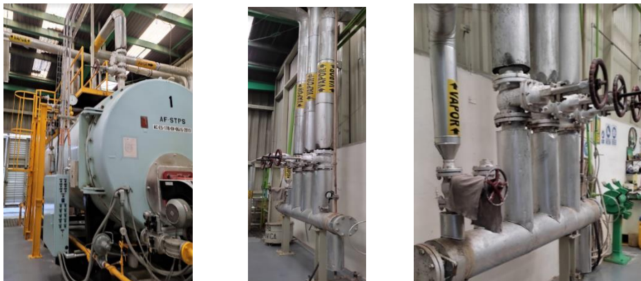
Figura 22. Fotografías del cuarto de calderas
