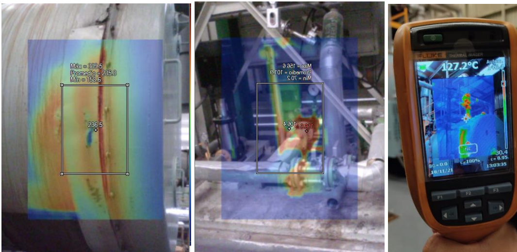
Figura 26: Termografías de puntos calientes identificados en el sistema termico.
