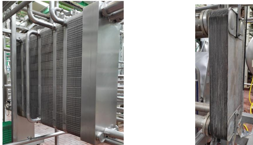
Figura 24. Fotografías los intercambiadores de calor de placas.
