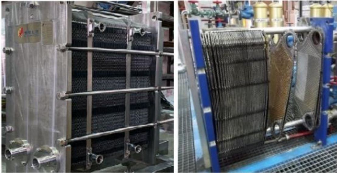
Figura 165. Intercambiadores de calor de placas
