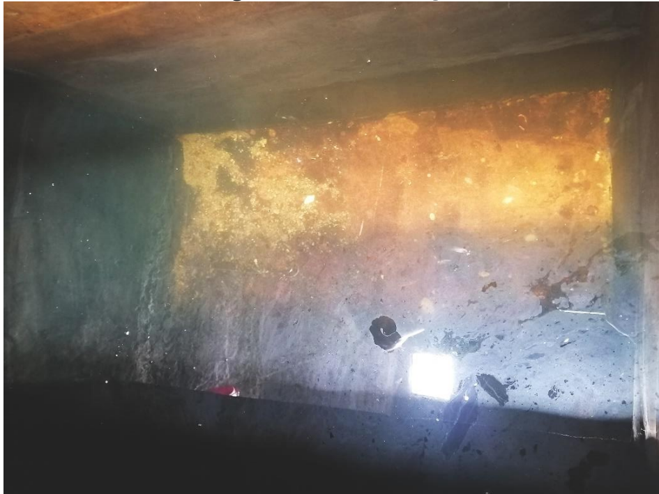
Imagen 6. Cisterna de agua.
