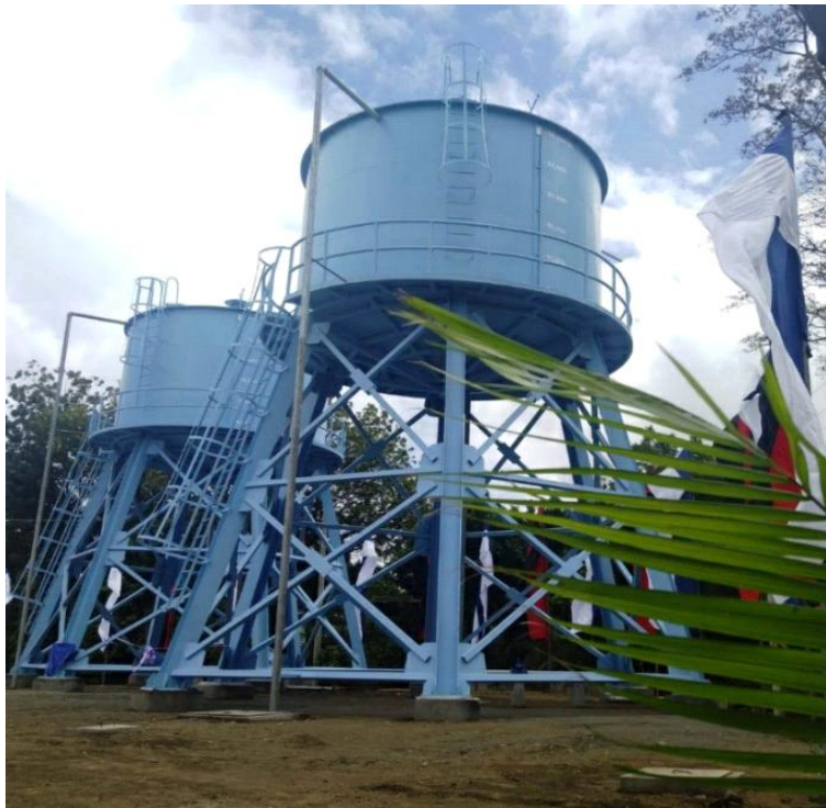
Figura 6.4 Tanques de almacenamiento de agua potable. Fuente 19 Digital
