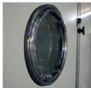
Mirilla de inspección para secciones de filtros y ventilador.
