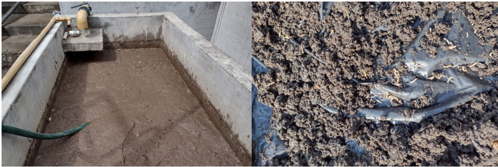
Figura 4.2: Izquierda: Lodos residuales en lecho de secado. Derecha: Lodos residuales deshidratados.
