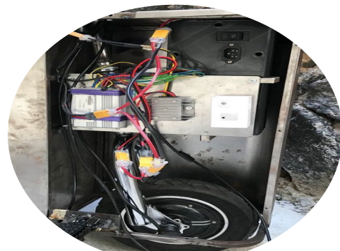
Ilustración 19 Cables desacomodados B
