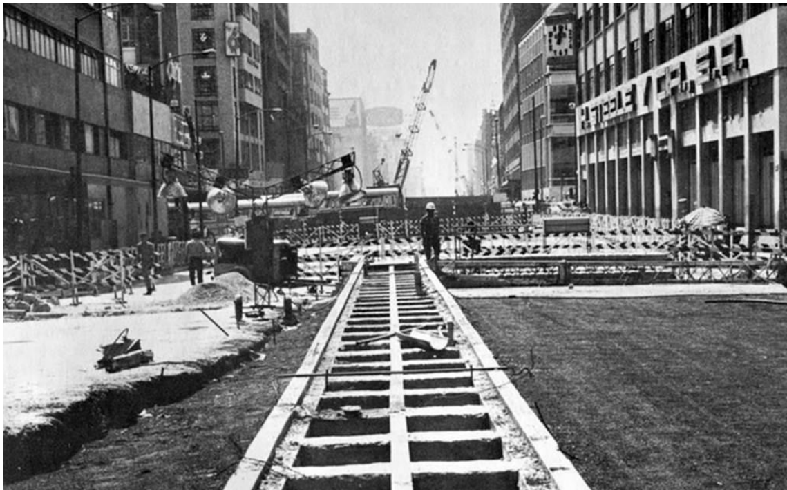
"Fotografía de la construcción del Metro en 1969" El Universal. Avenida Balderas, CDMX. México.
