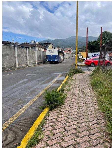
IMAGEN 2.52 cuenta banquetas en el exterior para los peatones, pero están muy angostas y en malas condiciones.
