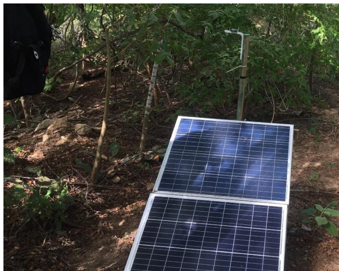
Figura 3.3. Celdas solares instaladas para cada estación temporal.
