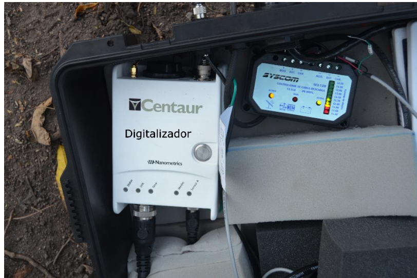
Figura 3.2. Digitalizador dentro de la caja de protección.
