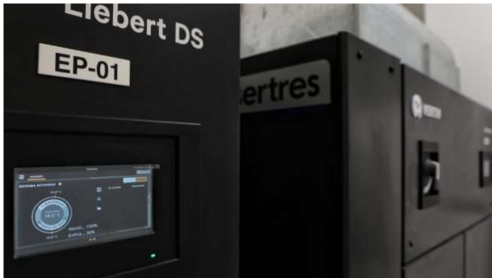
Ilustración 35. Fotografía de sistemas para el funcionamiento del Centro de Datos de la CDMX
