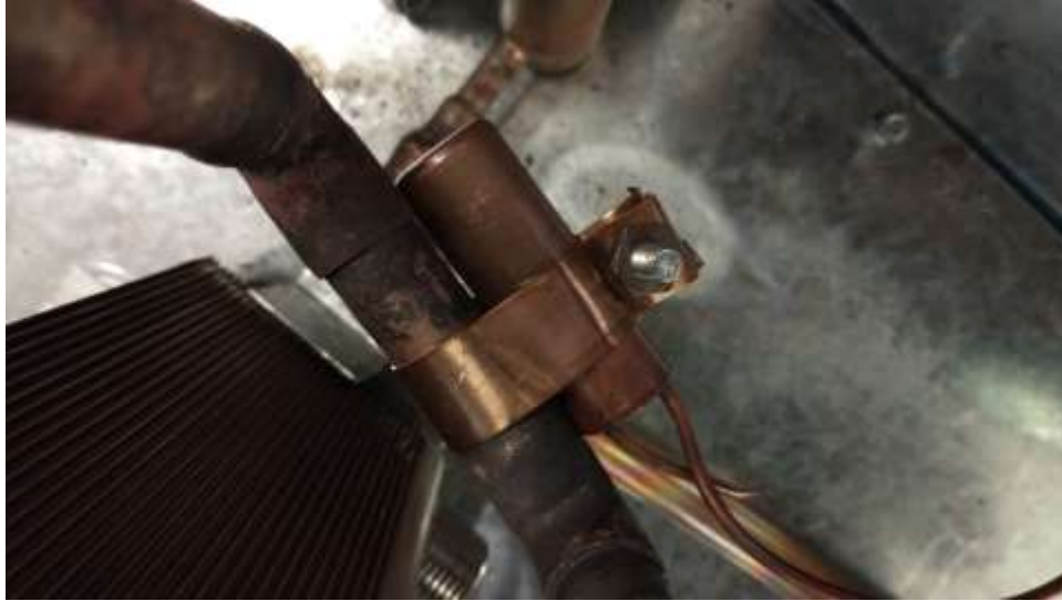
Imagen 153 Bulbo sensor de la válvula de expansión
