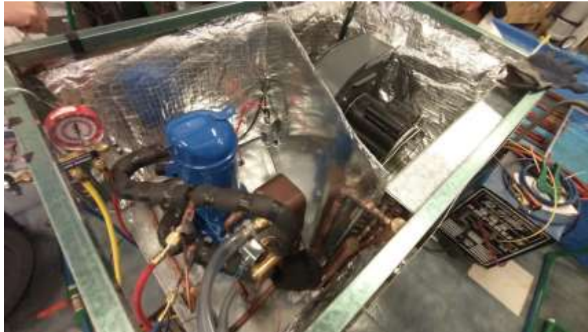
Imagen 158 Bomba de calor con conexiones eléctricas, aislamiento y conexiones al intercambiador geotérmico
