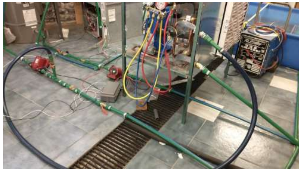
Imagen 163 Manguera conectada a la entrada del intercambiador de placas tomada de un tanque de agua
