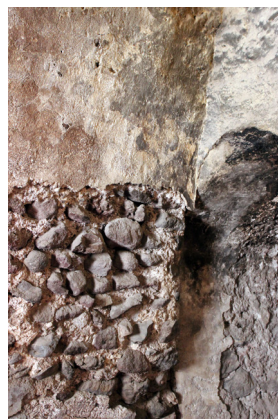
Figura 83. Detalle de muro en la cocina. Fotografía tomada el 16 de julio de 2022.
