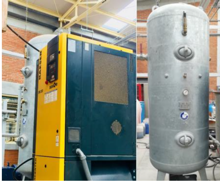
Figura 3.8: Compresor y tanque de almacenamiento de aire comprimido (Hernández, 2019).
