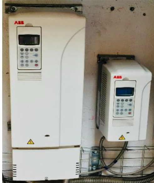
Figura 3.6: Variadores de frecuencia (Hernández, 2019).
