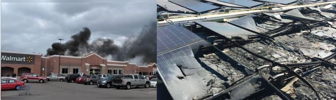
Figura 2.7: Incendios en Sistemas Fotovoltaicos de Walmart. [15][16]
