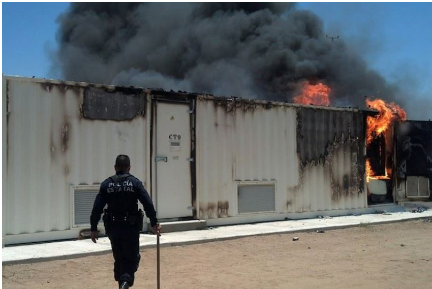
Figura 2.8: Incendio en módulo de transformación de Aurora Solar 1 [17]
