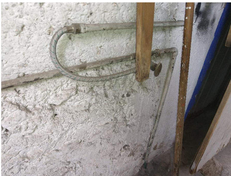
Imagen 50. Tuberías sin funcionamiento de la cual una está recortada Fuente: Fotografía tomada por autor, 2020
