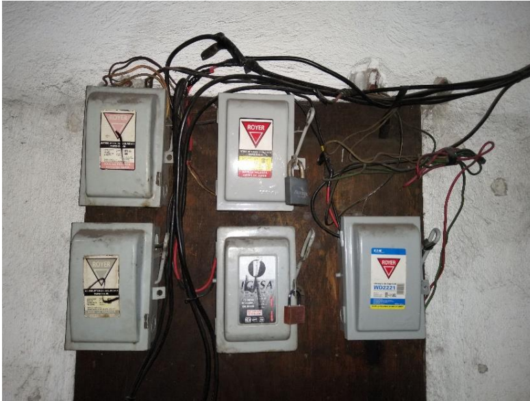
Imagen 52. Cajas de cuchillas con cables desgastados e irregulares que han provocado problemas. Fuente: Fotografía tomada por autor, 2020
