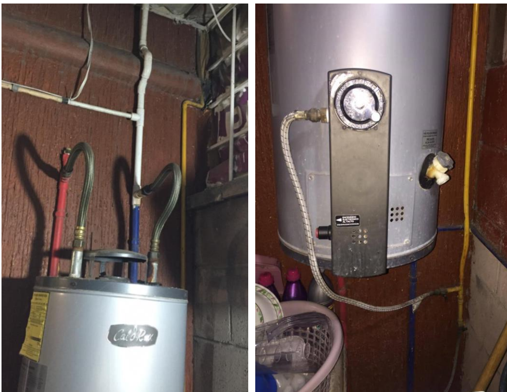
Imagen 101, 102. Nuevo calentador de agua con su instalación. Fuente: Fotografía tomada por autor, 2020
