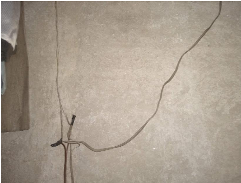
Imagen 53. Conexión eléctrica de planta baja a planta alta. Fuente: Fotografía tomada por autor, 2020
