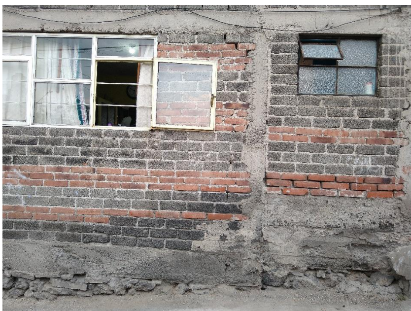
Imagen 38. Fachada oriente, donde se aprecian varillas de la cimentación expuesta. Fuente: Fotografía tomada por autor, 2020
