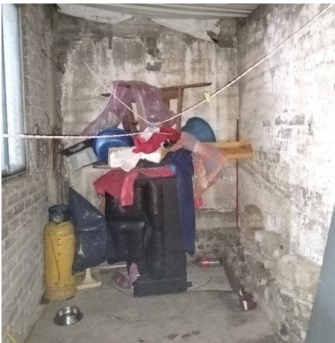
Imagen 61. Cuarto con muros sin acabado y otros con acabado deteriorado con piso aplanado de mortero. Fuente: Fotografía tomada por autor, 2020
