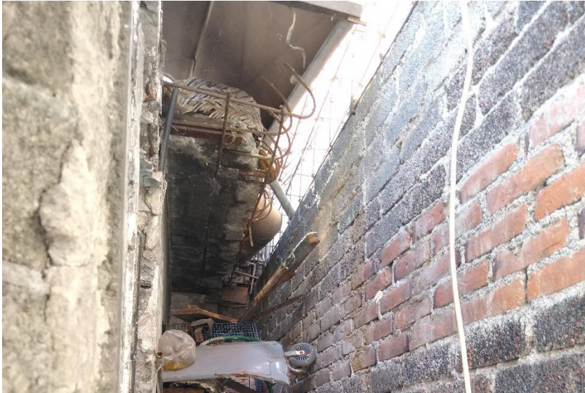
Imagen 39. Varillas y concreto de losa cortada. Fuente: Fotografía tomada por autor, 2020
