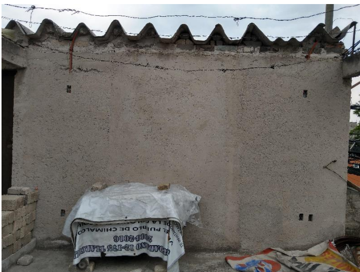
. Imagen 44. Lámina asbesto en planta alta. Fuente: Fotografía tomada por autor, 2020
