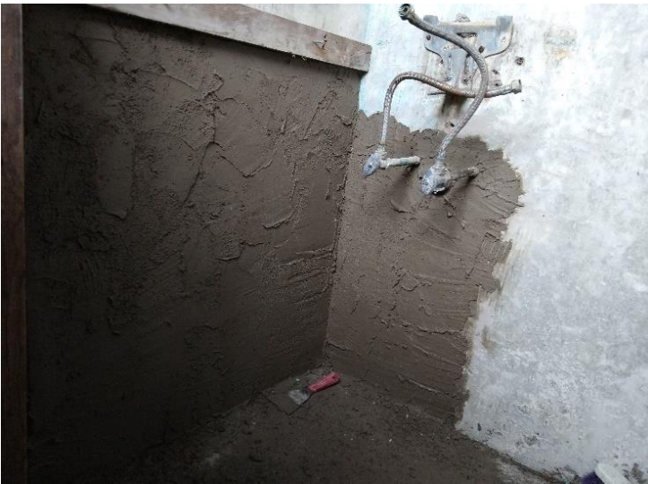
Imagen 47. Instalación hidráulica de lavabo. Fuente: Fotografía tomada por autor, 2020
