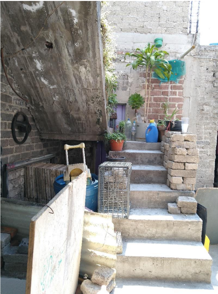
Imagen 73. Escaleras con varios problemas. Fuente: Fotografía tomada por autor, 2020
