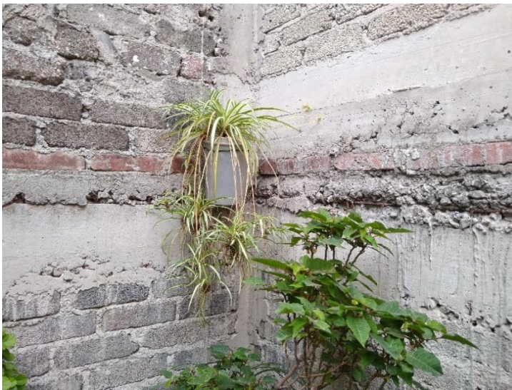
Imagen 43. Lámina asbesto en planta alta. Fuente: Fotografía tomada por autor, 2020
