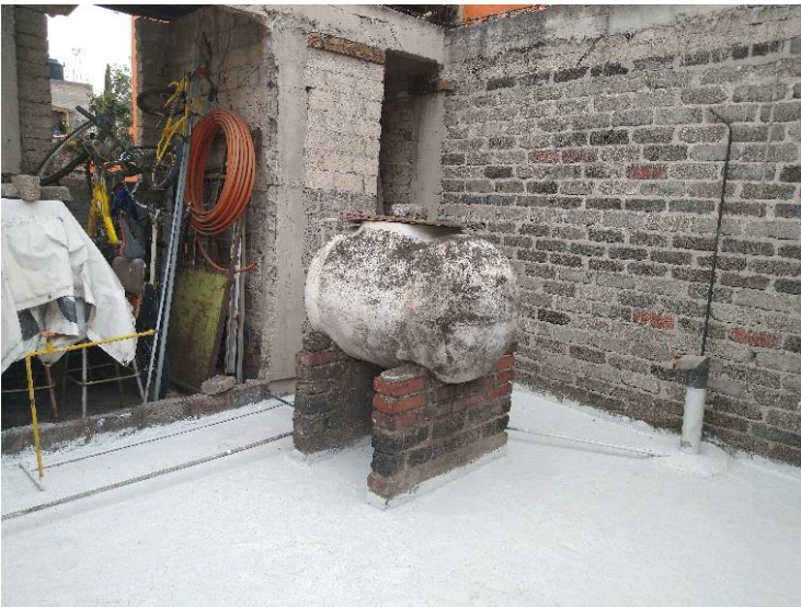
Imagen 48. Tinacos de asbesto, se aprecian tuberías que estorban el paso. Fuente: Fotografía tomada por autor, 2020
