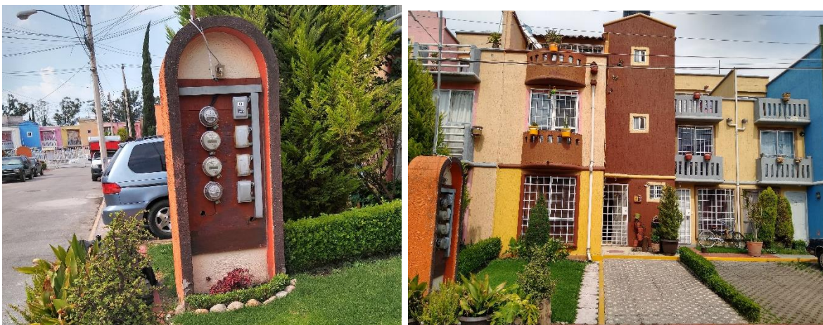
Imagen 105, 106. Arco donde se ubica la acometida, medidores y caja de cuchillas de 4 viviendas, esta se encuentra al exterior de la casa. Fuente: Fotografía tomada por autor, 2020
