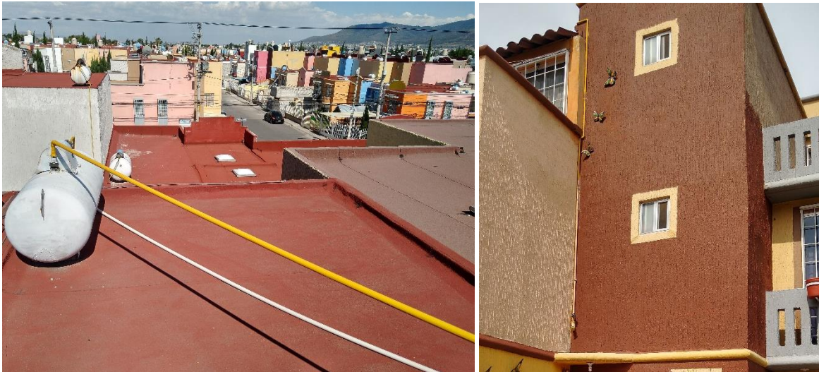
Imagen 103. Gas estacionario con su instalación a una altura de 50 cm del nivel de piso terminado. Imagen 104. Toma de la instalación de gas puesta en la parte exterior de la casa. Fuente: Fotografía tomada por autor, 2020
