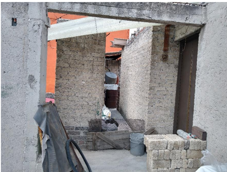
Imagen 74. Vestíbulo al subir las escaleras, se aprecia una cubierta improvisada y alambres peligrosos. Fuente: Fotografía tomada por autor, 2020
