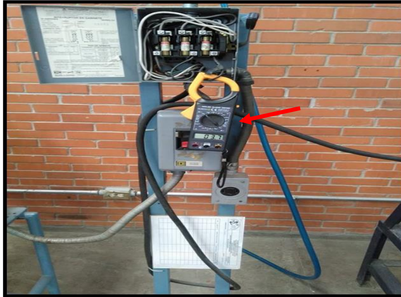
Figura 2. 6 Determinación de voltaje con multímetro.
