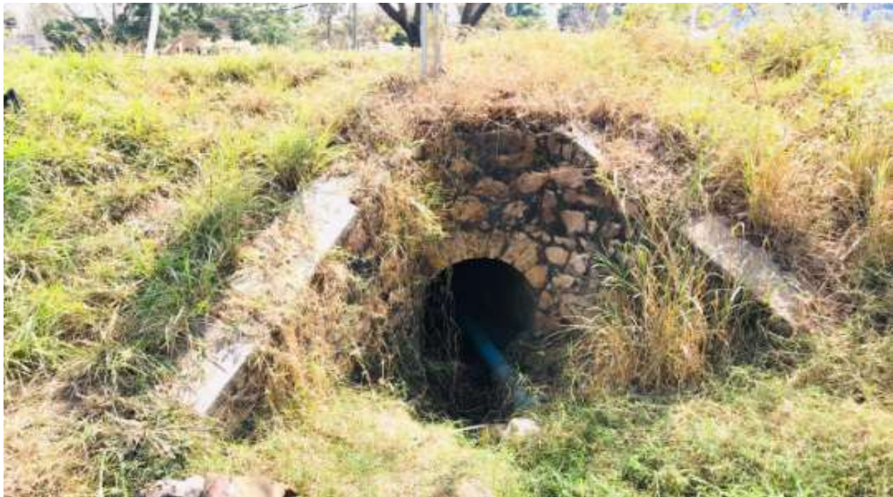
Figura 12 – Estado actual del alcantarillado en el km 10+550, de la carretera Panamericana, (Berriozábal, Chiapas).
