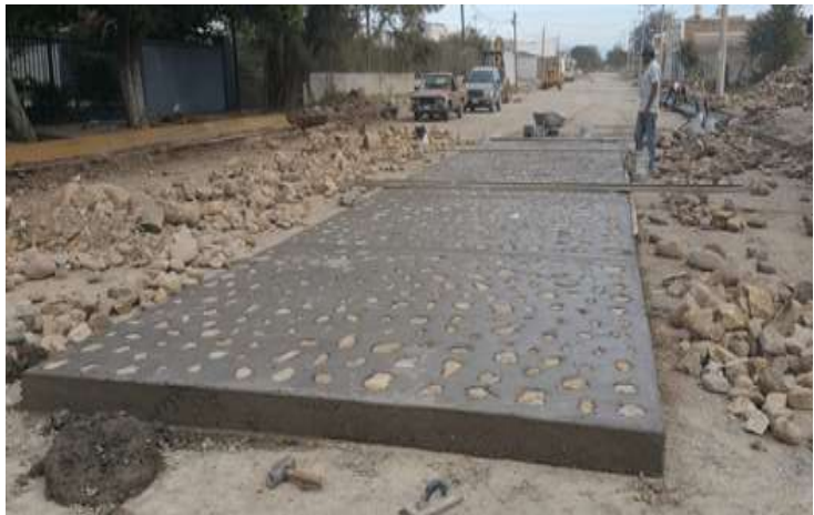
Figura 73 – Zampeado de Mampostería.
