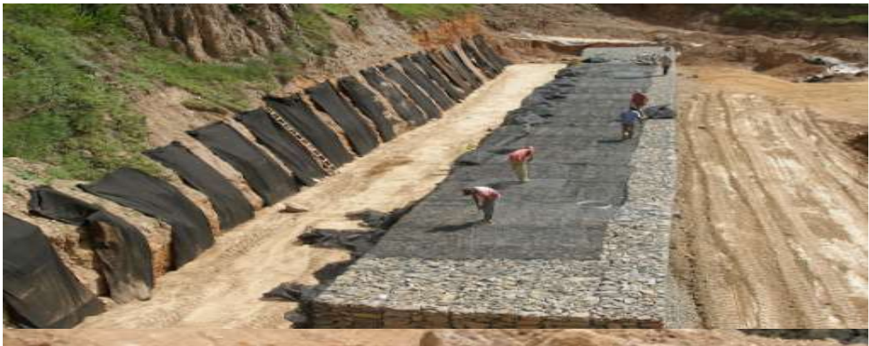
Figura 45 – Llenado de canastas con material de piedra, para construcción del muro gavión.
