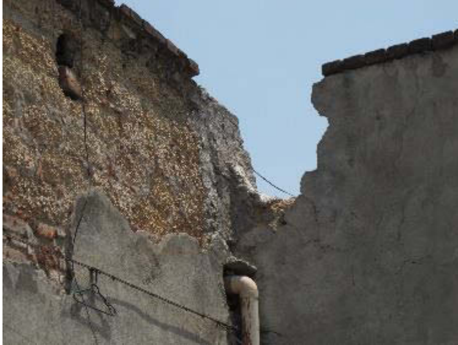
Imagen 25. Colapso parcial de muro y recubrimiento. Fuente: Elaboración propia.
