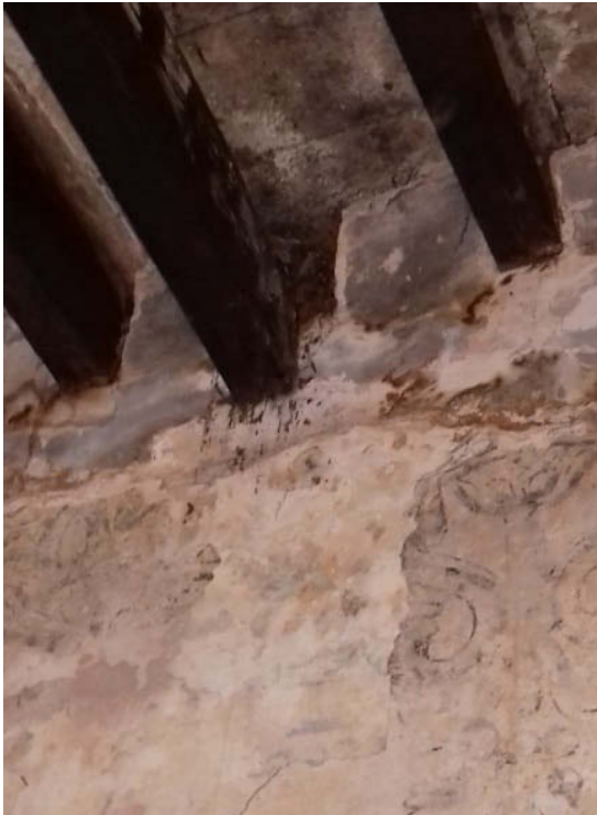
Imagen 27. Desprendimiento de vigas. Fuente: proporcionada por habitantes
