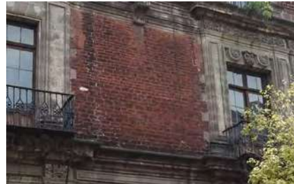
Fachada: de tezontle rojo, presenta escurrimientos.
