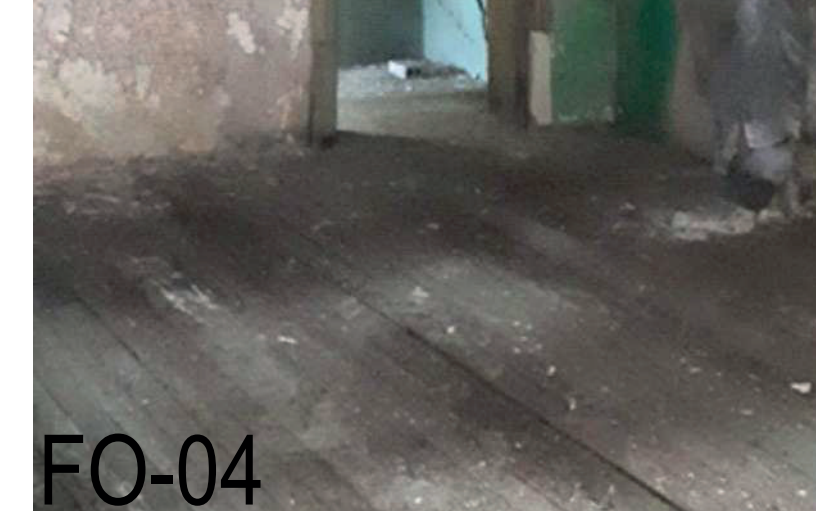
FO-04 ENTREPISO VIGAS Y BARROTES DE PINO, CON DUELA DE MADERA FOTOGRAFÍA PROPIA TOMADA EN AGOSTO 2019
