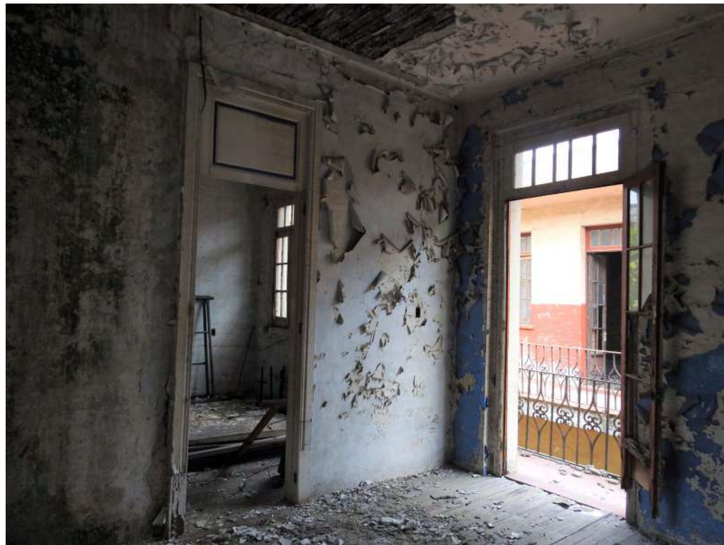
Cuarto-vestíbulo con humedad.
