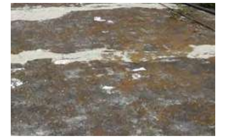
Azotea entrepiso concreto sin enladrillado o algún tipo de acabado.
