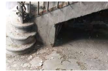
Pérdida de esterotomía en escaleras y oxidación en barandal.
