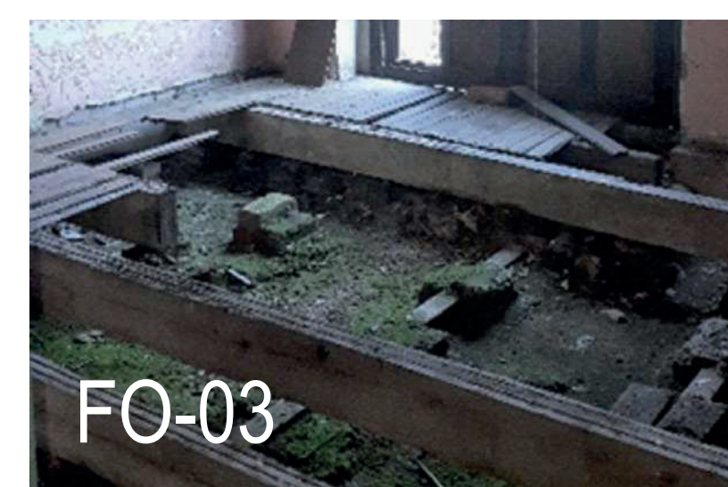
FO-03 ENTREPISO VIGAS Y BARROTES DE PINO, CON DUELA DE MADERA FOTOGRAFÍA PROPIA TOMADA EN AGOSTO 2019
