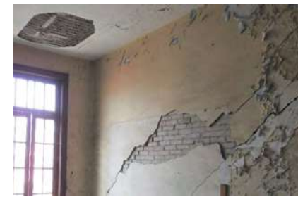
Muro divisorio con fisuras y grietas.
