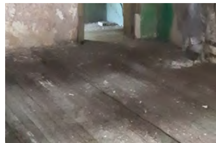
Piso de duela con húmedad.
