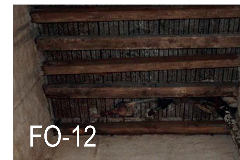
FO-12 LOSA A BASE DE VIGAS DE MADERA FOTOGRAFÍA PROPIA TOMADA EN AGOSTO 2019
