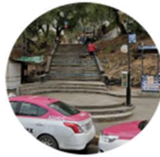
[Imagen 84]: Única subida en mal estado
