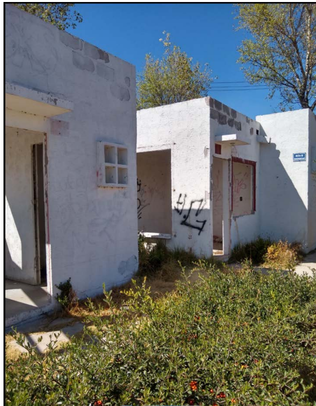
Fotografía 38. Área vandalizada en Geoparque
