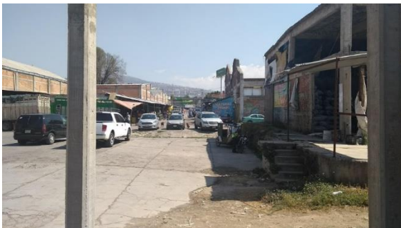
Figura 27 Foto del desnivel en piso, Fuente. Elaboración propia, 5/03/19.
