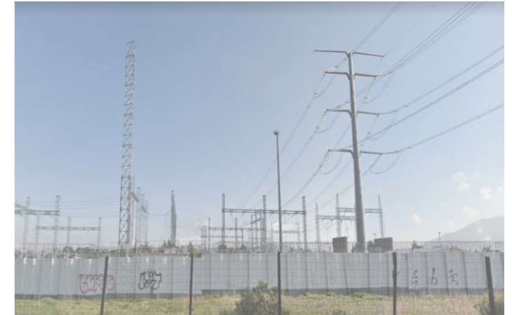
07 SUBESTACIÓN ELÉCTRICA CFE
