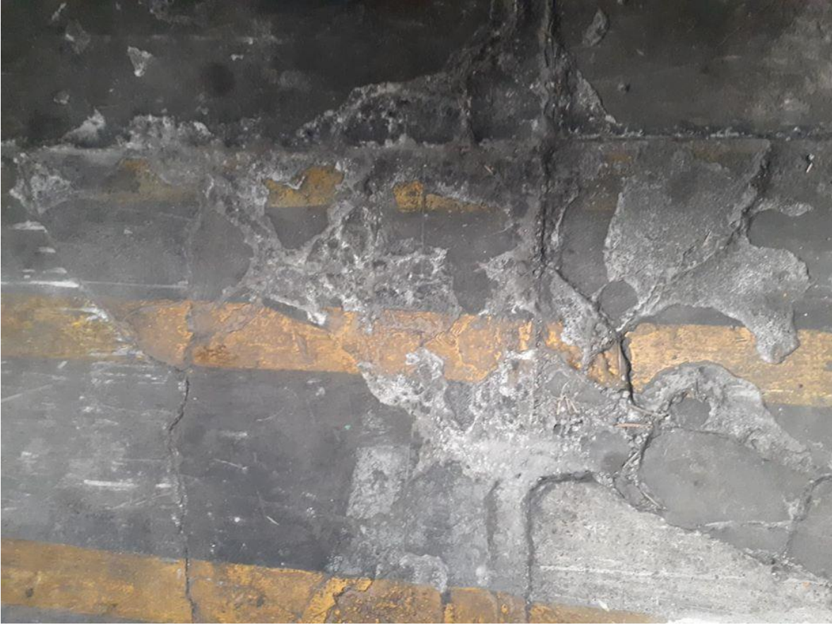
Figura 3.15 Descascarado, desportillamiento, superficie polvosa.
