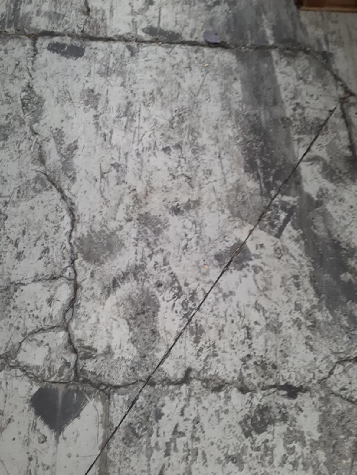
Figura 3.13 Grieta desportillada, agrietamiento aleatorio.
