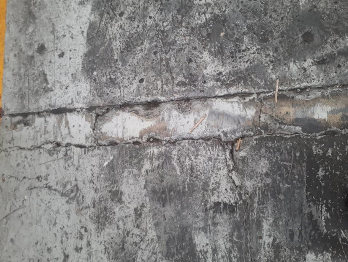
Figura 3.14 Descascarado y junta desportillada.
