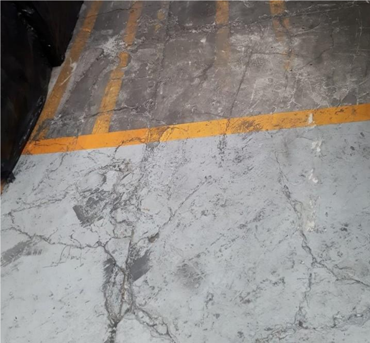
Figura 3.9 Agrietamiento aleatorio, descascarado.
