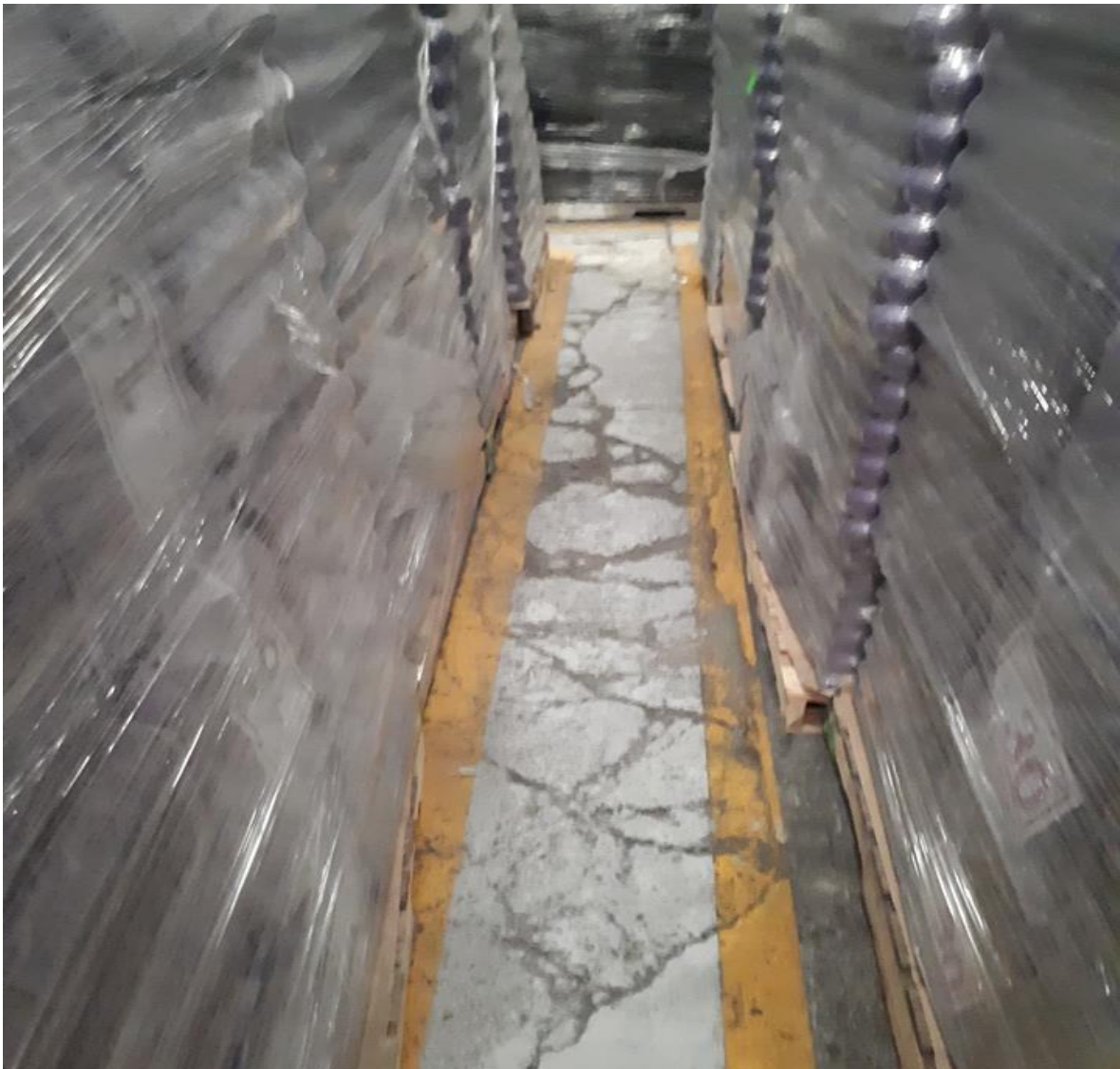
Figura 3.8 Agrietamiento por asentamiento con desportillamiento.
