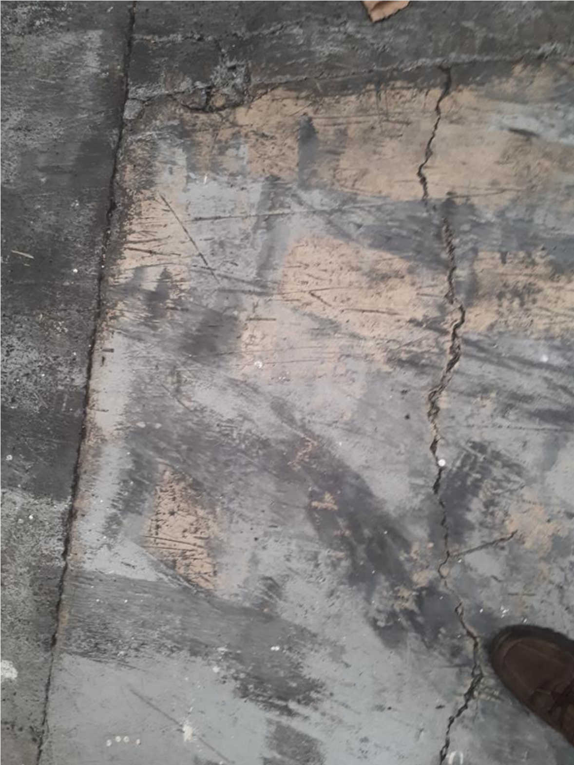
Figura 3.12 Agrietamiento aleatorio y por contracción, junta desportillada.
