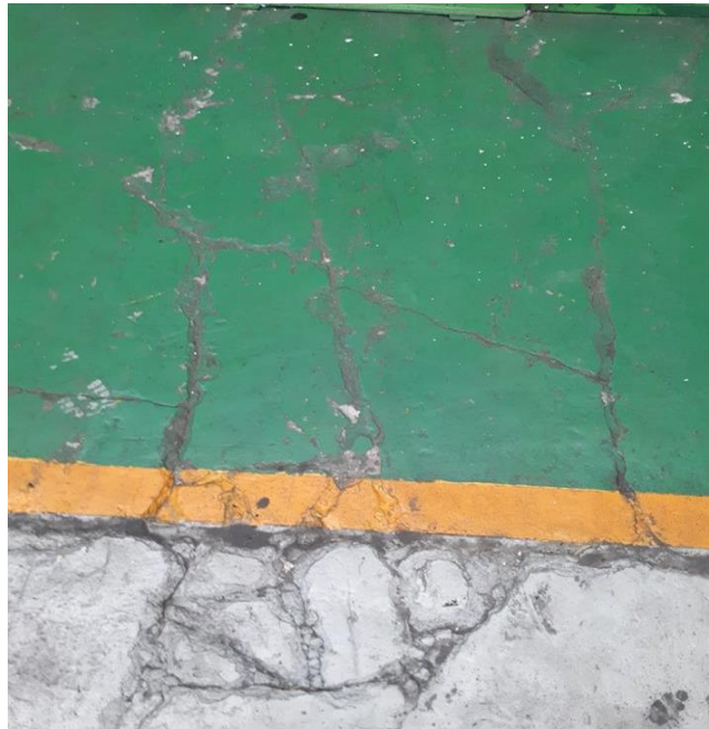
Figura 3.11 Descascarado, desportillamiento, superficie polvosa, agrietamiento.
