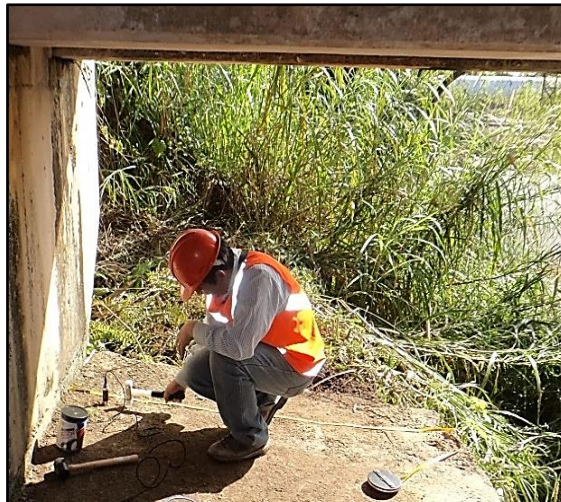
Figura 32. Realización de pruebas PIT sobre uno de los apoyos del puente. Fuente: (Sergben, Ingeniería del Subsuelo S. A. de C. V., 2013).
