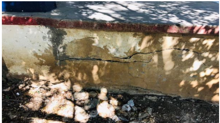
FIG. 11 FRACTURAS EN ESTRUCTURAS DE CIMENTACIÓN.
