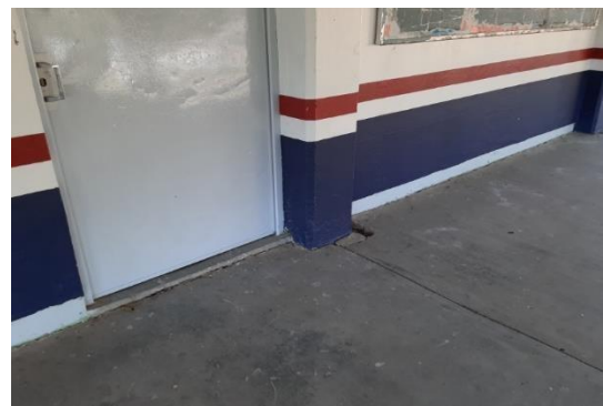
FIG. 63 GRIETAS EN LOSAS DE CIMENTACIÓN.
