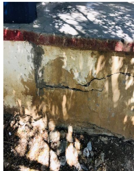
FIG. 58 FRACTURA POR CORTANTE EN SUBESTRUCTURA EN BIBLIOTECA (COBACH 19).
