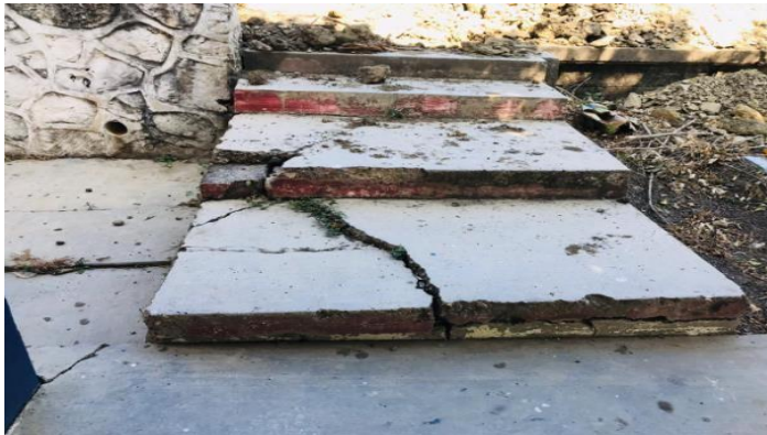
FIG. 9 FRACTURAS DE LAS BANQUETAS.
