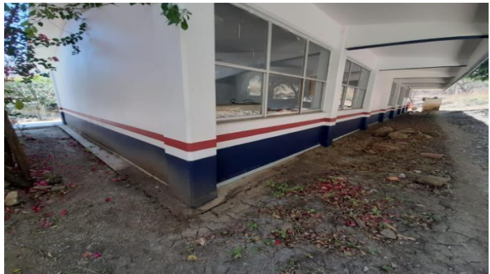
FIG. 12 HUNDIMIENTO DE LAS INSTALACIONES.
