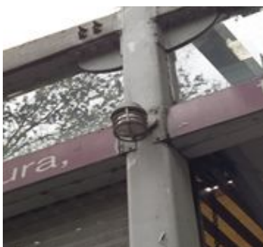
Imagen 35. Luces ubicadas en el acceso 9 Grutas.
