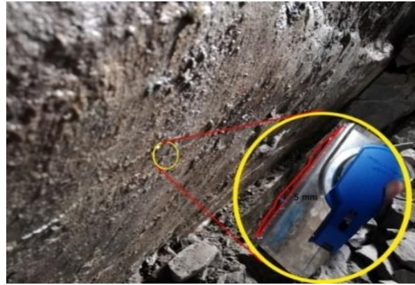
Figura 63. Rugosidad y ondulación de una pared de discontinuidad en el frente del túnel cadenamiento 0+196.
