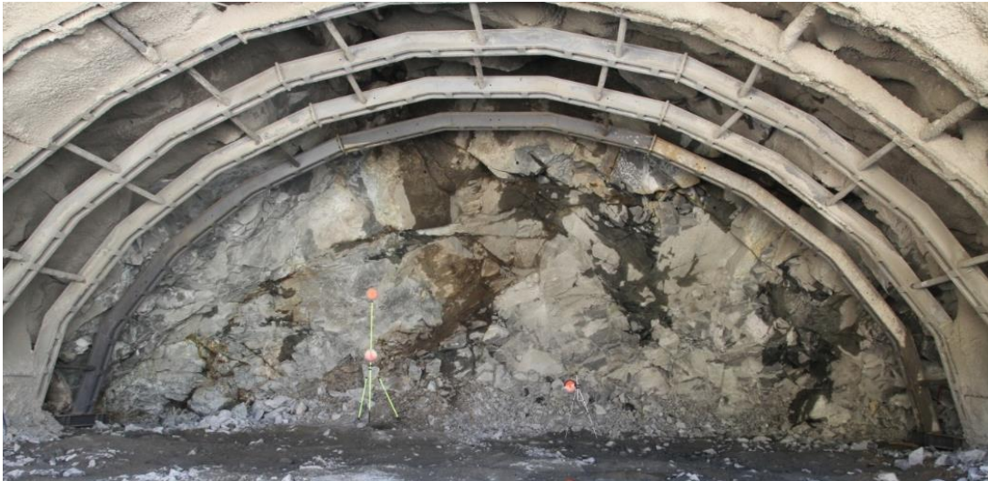
Figura 72. Frente de excavación No. 01, cad. 0+187. Macizo rocoso muy fracturado. Se indican las fracturas principales sobre el frente de excavación.
