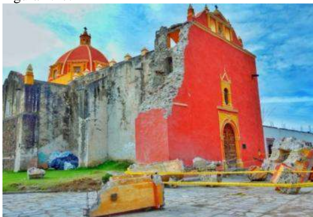
Figura 2.17. Caída de torre campanario en Parroquia de San Esteban Protomartir, Tepetlixpa, Estado de México.
