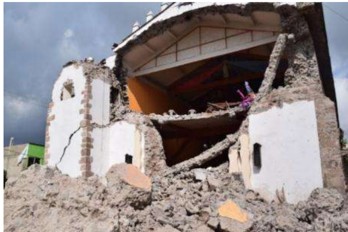
Figura 2.13. Caída de fachada en Parroquia de Santiago Apóstol, Atzala.
