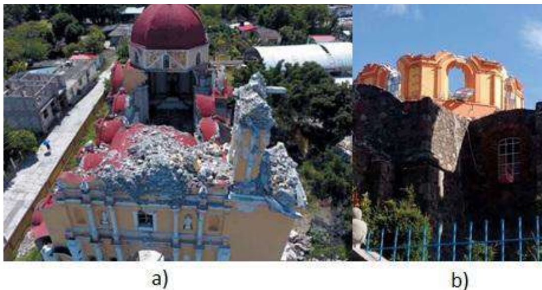
Figura 2.21. Caída de bóveda y torre campanario en parroquia de Santiago Apóstol, Atzala, Pue, b) Desplome de cúpula.
