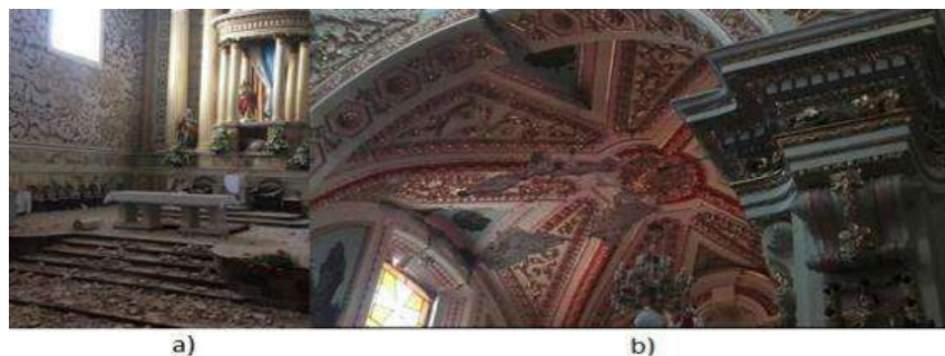
Figura 2.19. a) Desprendimiento de acabados y daño en pinturas a catedral de la Natividad, en Atlixco, Pue., b) Fracturas y grietas en capilla principal de la catedral de Jesús Tlatempa, en San Pedro Cholula, Puebla.
