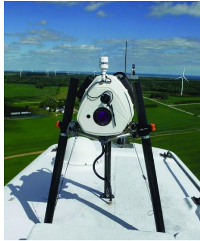
Figura 37, Instalación de Sistema LIDAR ZX TM sobre Generador eólico.
