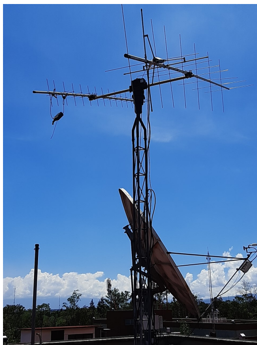
Figura 3.5: Antenas tipo yagi VHF y UHF de la estación terrena
