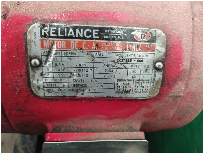
Anexo 5. Datos de placa motor del compresor 40
