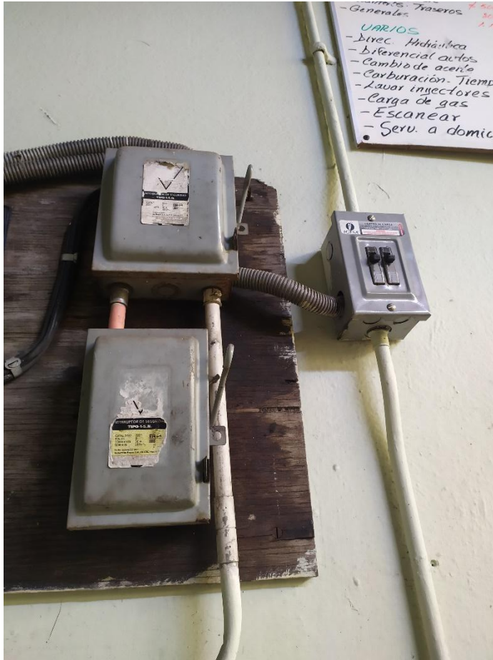
Anexo 11. Caja de Fusibles
