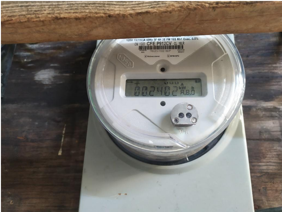
Anexo 12. Medidor de CFE
