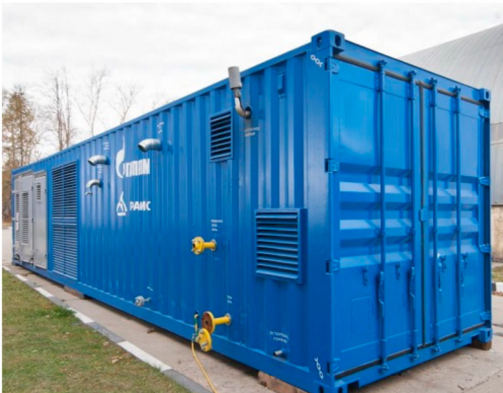
Figura 25. Unidad generadora de nitrógeno (CJSC GRASYS, 2015)
