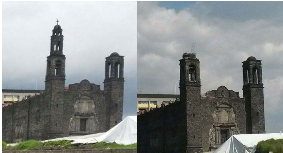
Figura 30 | G.I. (2017, 20 septiembre). Se derrumba torre de iglesia en Tlatelolco por sismo [Fotografía]. López Dóriga Digital. ( https://lopezdoriga.com/nacional/se-derrumba-torre-de-iglesia-en-tlatelolco-por-sismo/ ). A la izquierda: la Iglesia en años anteriores a su colapso, a la derecha: resultado del colapso de la parte superior de la torre, hoy el atrio y el interior de la iglesia se encuentran apuntalados ante un posible derrumbe.
