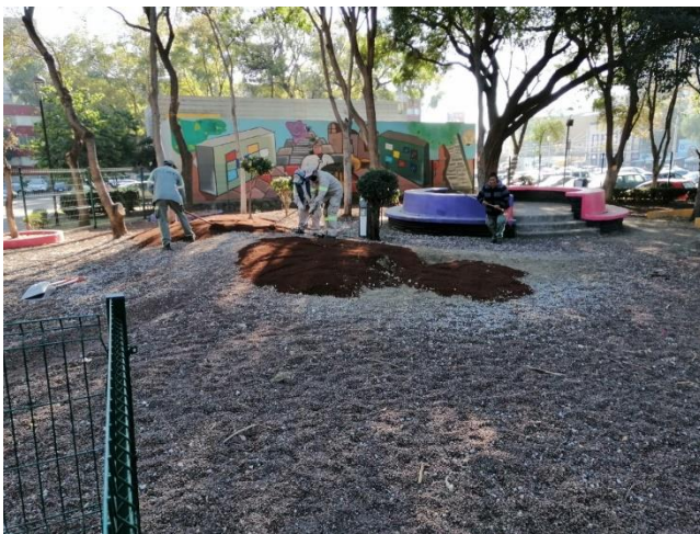
Figura 45 | Quiroz, M. (2020, 15 diciembre). Área Canina [Fotografía]. ( https://www.facebook.com/photo?fbid=863014634444232&set=gm.3731075673615898 ). Colocación de tezontle par área canina.
